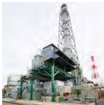
CO 2 排出を削減している ガスタービン（東ソー㈱）
