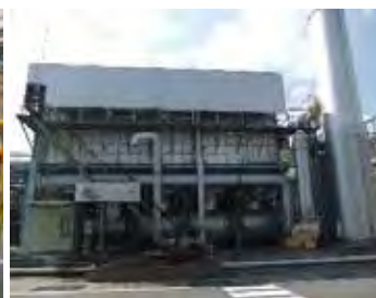
蓄熱燃焼式排ガス処理施設 （㈱ENEOS マテリアル）
