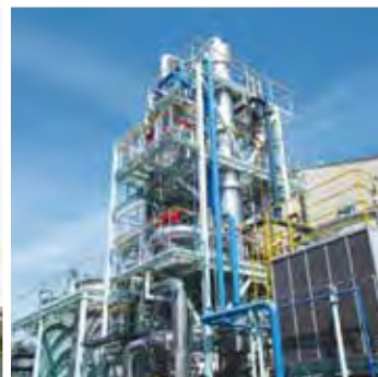
排水中のアンモニア低減を目的と したアンモニアストリッピング設備 （石原産業㈱）
